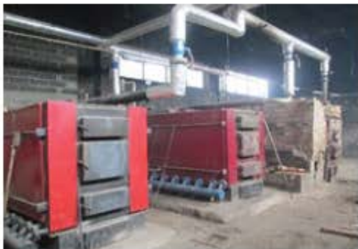
2.8. ATTĒLS: Mežāres katlu mājas ūdenssildāmie katli
