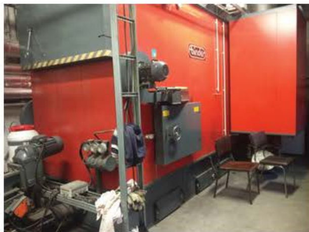
2.15. ATTĒLS: Apkures katls Staļģenes vduisskolā
