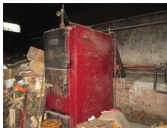
2.5. ATTĒLS: Apkures malkas katls
