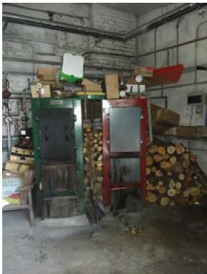
2.10. ATTĒLS: Bērzupes speciālās internātpamatskolas malkas apkures katls
