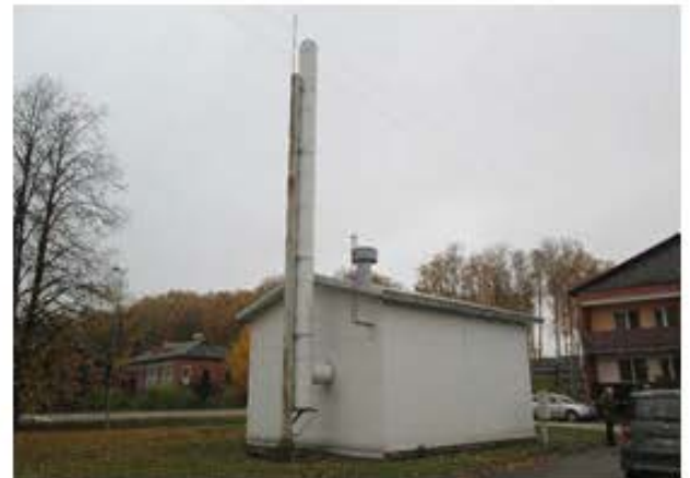
2.11. ATTĒLS: Konteiner tipa dabasgāzes katlu māja Aizkraukles pagastā
